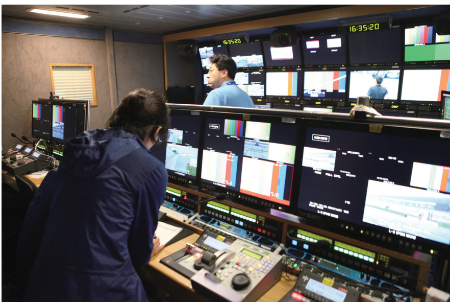
CSC(commentary switching center) 디지털화된 CSC(commentary switching center)도 주목할 만하다. 아날로그 신호들이 들어오던 이전에는 마치 전화국 같은 느낌이었었는데 디지털로 바뀌면서 모든 장비가 소형화됐다. 뿐만 아니라 이전에는 장비 세팅을 위해 운영자들이 각 경기장에 무조건 배치됐어야 했는데 디지털로 바뀌면서 전문가들이 현장에 나가지 않아도 컨트롤이 가능해졌다.
